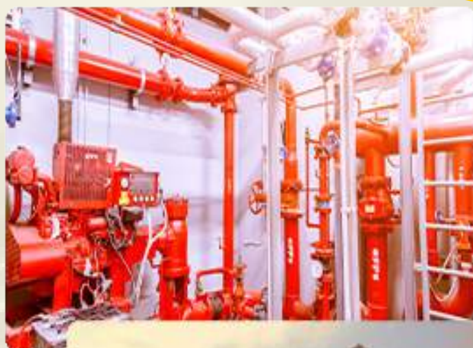
Xin cấp phép phòng cháy chữa cháy
